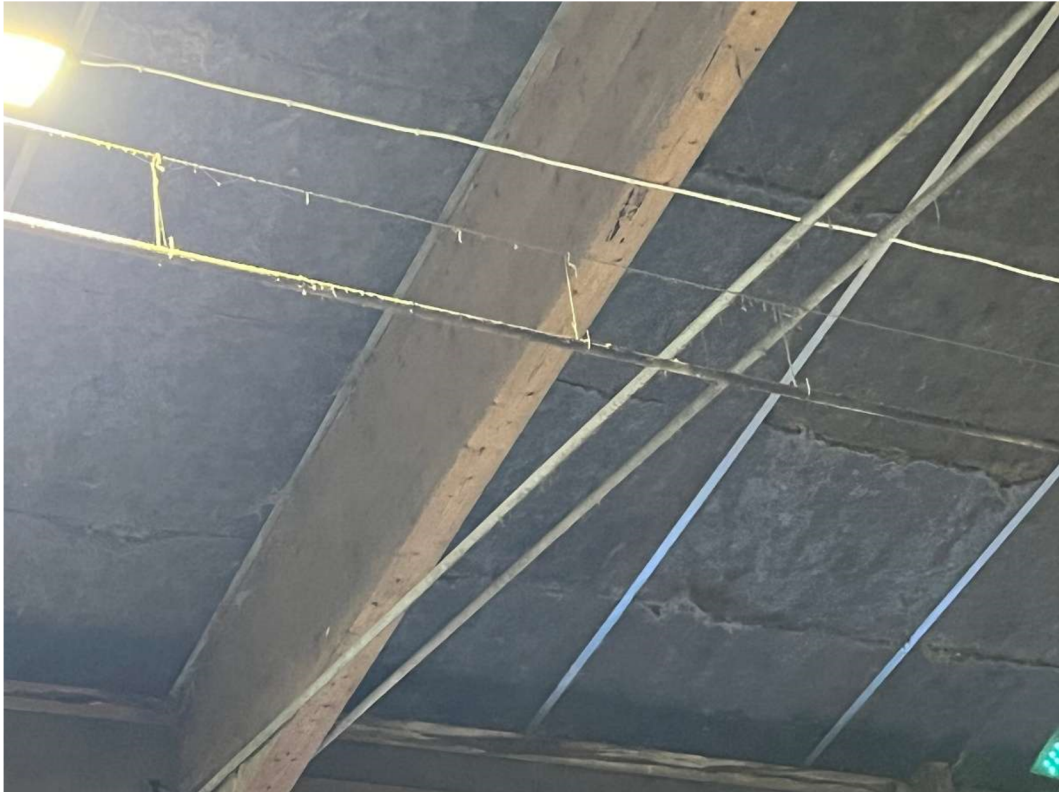
Nuvarande bevattningsanläggning, bevattningrör med dysor upphängt i bärvajer.
